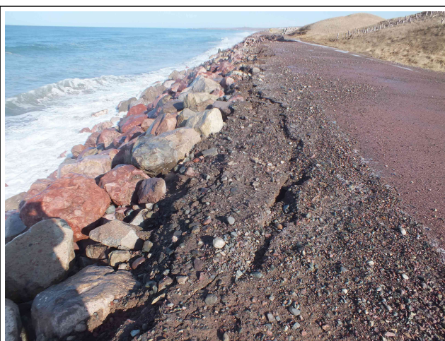
Apparition de nouveaux affaissements en aval
