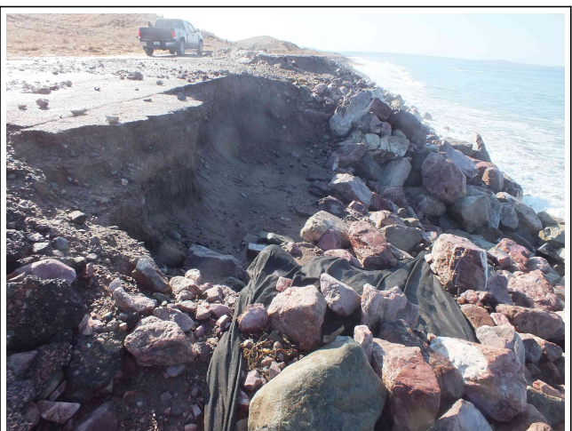
Glissement et effondrement sur la zone aval avec géotextile
