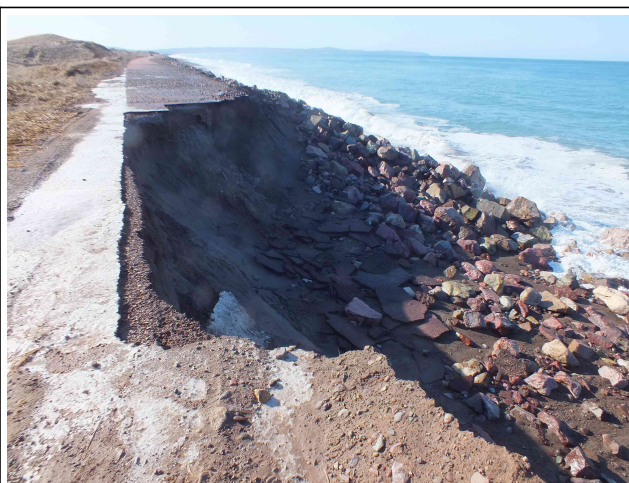
Nouvel effondrement au droit des renards aval
