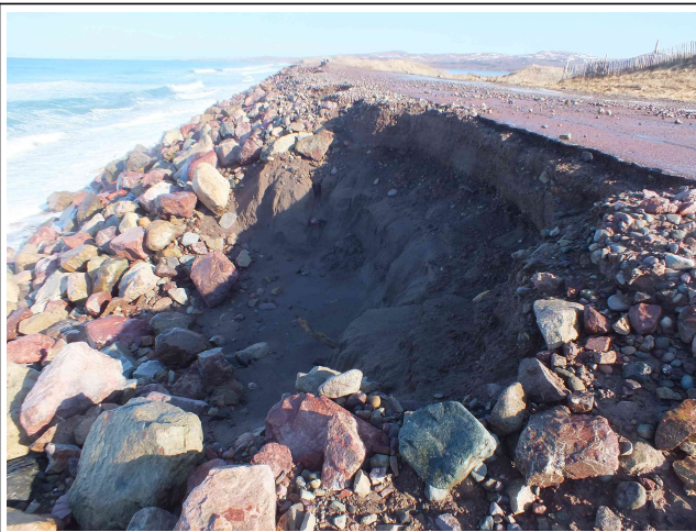
Nouvel effondrement devant l'effondrement central
