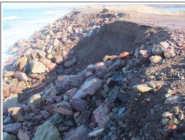
Élargissement de l'effondrement après celui de la partie digue amont
