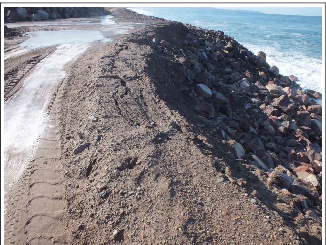
Glissement des enrochements de protection de l'effondrement central
