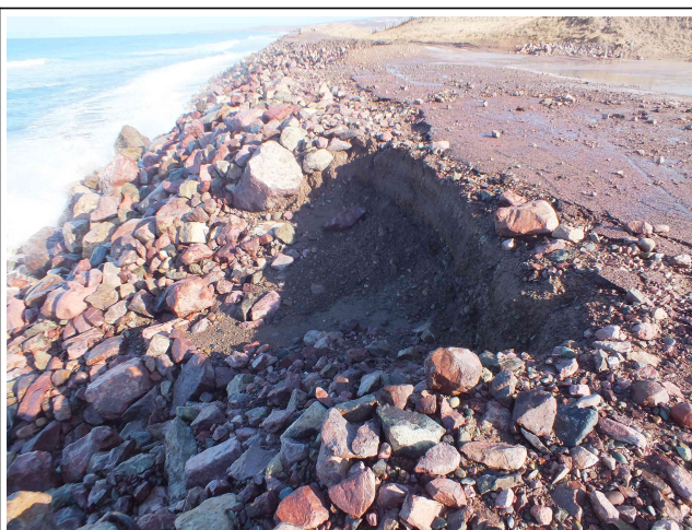
Nouvel effondrement après l'effondrement central sur les enrochements mis en février
