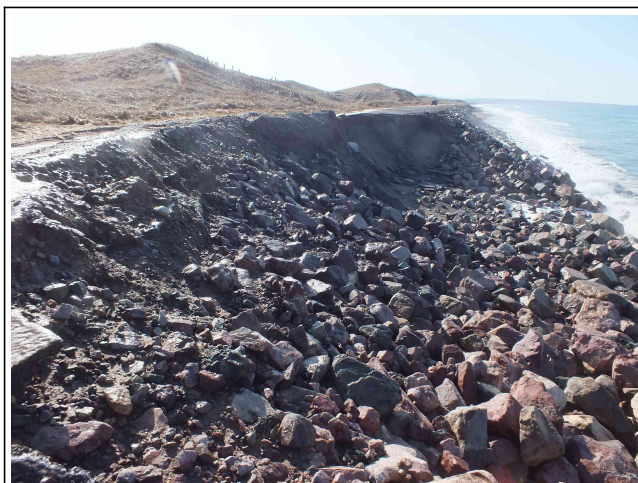
Élargissement de l'effondrement aval
